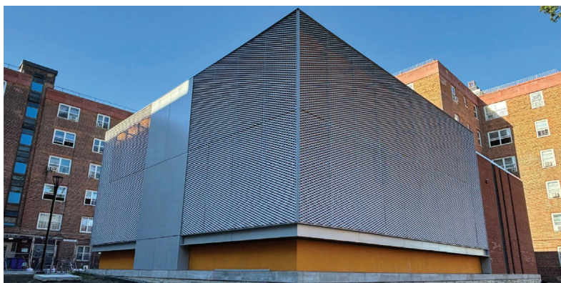
Red Hook West 住宅区已建成的室外公用设备房 来源: NYCHA Recovery and Resilience · 2025
